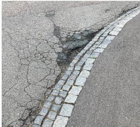
Abbildung 27: Zustand Randbereiche der Straße
